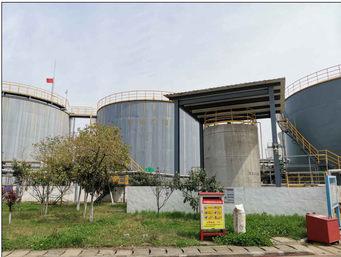
图 3.2-2 硫酸罐区现场照片
