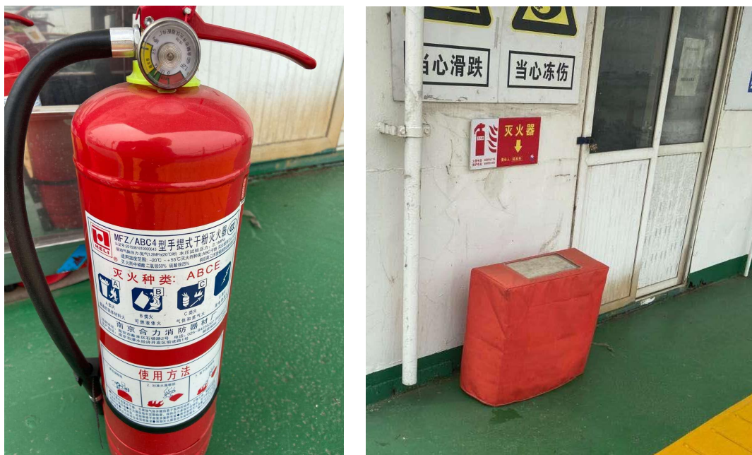
图 3.3-4 码头平台灭火器现场照片
